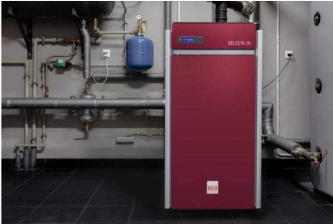
Kotły czyszczone ręcznie
